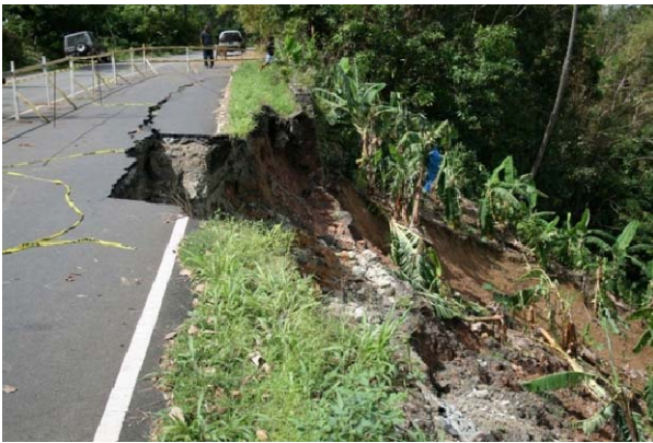
Barre de L'Isle Road Failure
